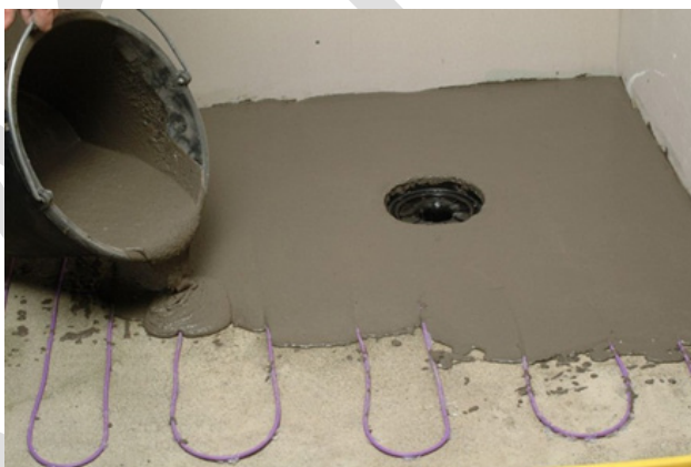
Figur 2: For produkter som blir skjult i en konstruksjon f.eks. støpemasser, membraner mm leveres det kun "som bygget" dokumentasjon.
